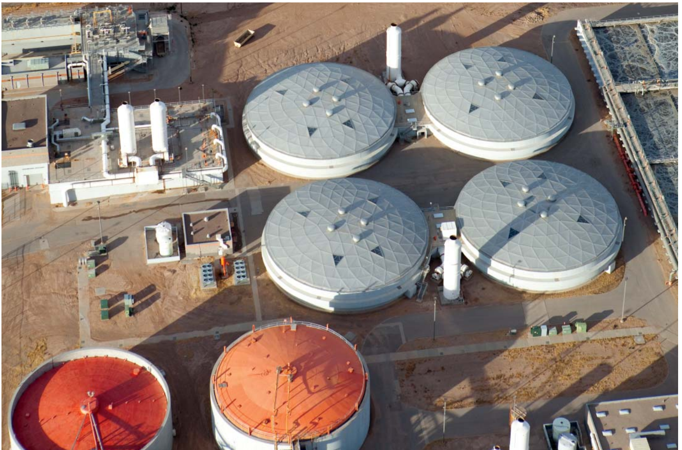
Planta de tratamiento de aguas residuales en El Paso, Texas. ©Krista Schlyer
