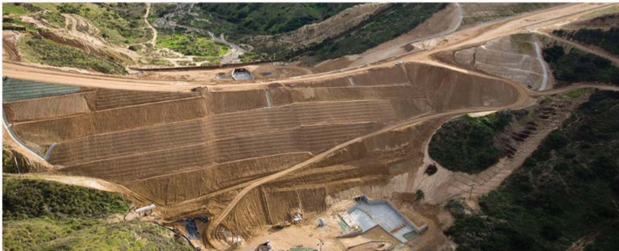
Foto 3: Construcción del camino de acceso y el cerco fronterizo en el Barranco del Contrabandista (Smuggler's Gulch) cerca al estuario de Tijuana.
