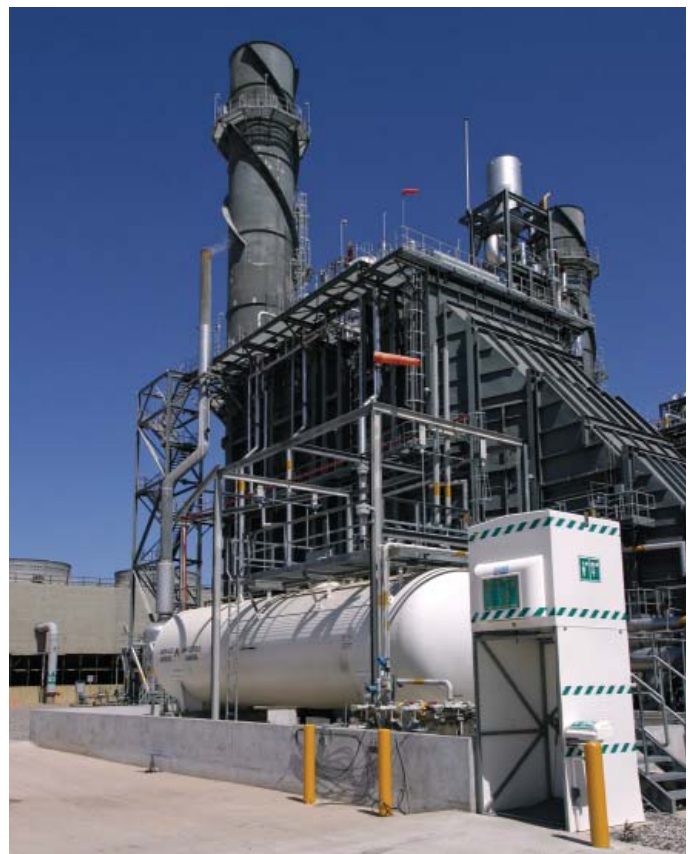
Planta termoeléctrica InterGen en Mexicali que produce electricidad para el Sur de California y Baja California. Con uso de gas natural como combustible, su ubicación en la cuenca atmosférica de Mexicali-Valle Imperial, que está fuera de cumplimiento, fue controversial. ©Paul Ganster
