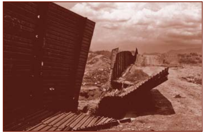
La instalación de cercas de seguridad sin planificación adecuada que consideren factores ambientales tales como el escurrimiento de aguas pluviales, puede producir erosión acelerada y una consecuente inestabilidad. (Fuente: Comisión Internacional de Límites y Aguas)
