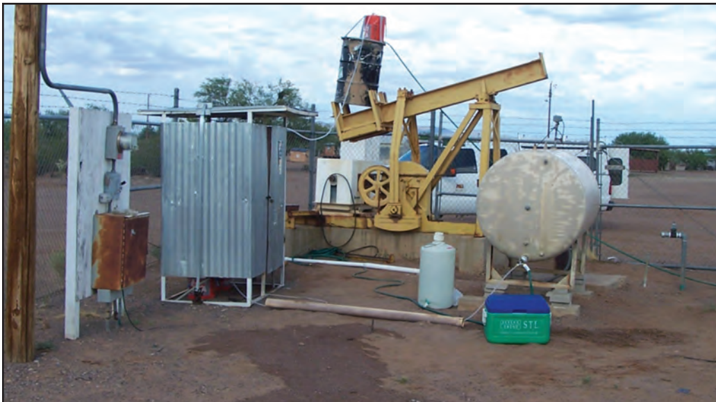
Investigadores de la Universidad Estatal de Arizona prueban un sistema de tratamiento de bajo costo para eliminar arsénico y nitratos del agua subterránea en las tierras de los Tohono O'odham, cerca de Sikul Himatk, Arizona.
