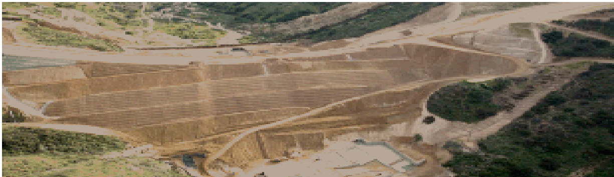
Foto 3: Construcción del camino de acceso y el cerco fronterizo en el Barranco del Contrabandista (Smuggler's Gulch) cerca al estuario de Tijuana.
