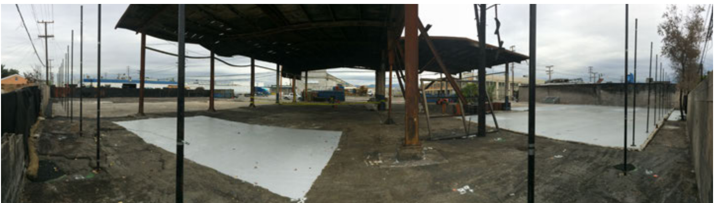
Ejemplo del área en donde un sello epóxico ha sido aplicado
