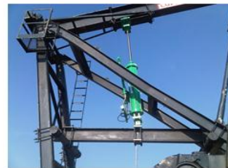
Pozo Llanito 114, Montaje tipo Samson .
