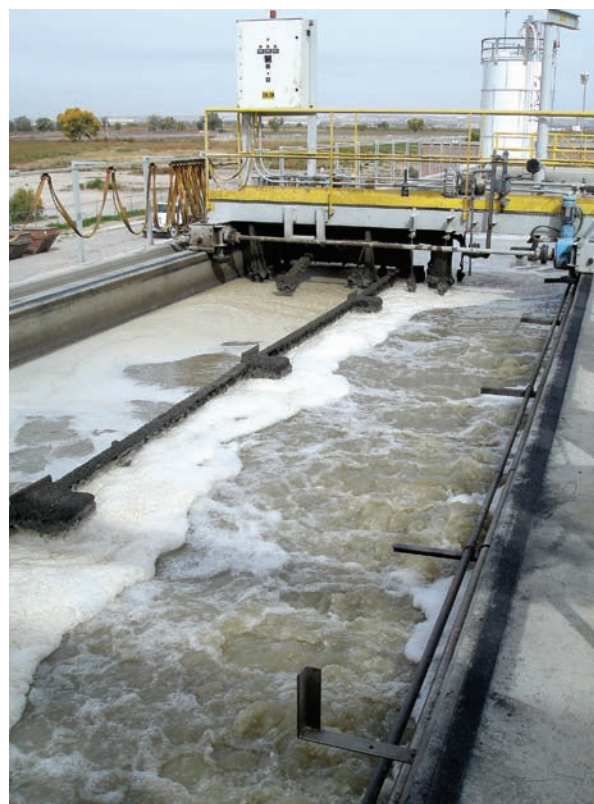
Planta de Aguas Residuales
