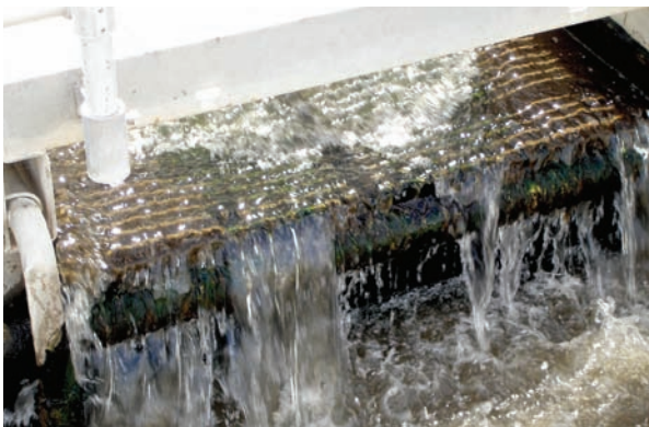
Planta de aguas residuales 2
