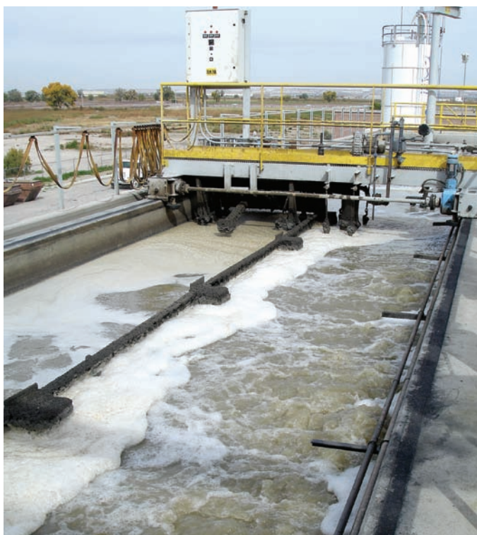
Vista de Instalaciones de Tratamiento de Aguas Residuales
