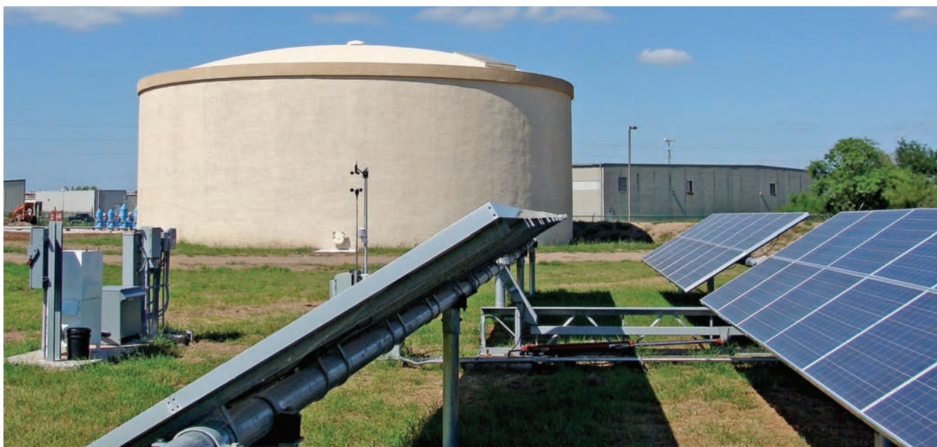
Arreglo Solar en la Planta de Tratamiento San Benito
